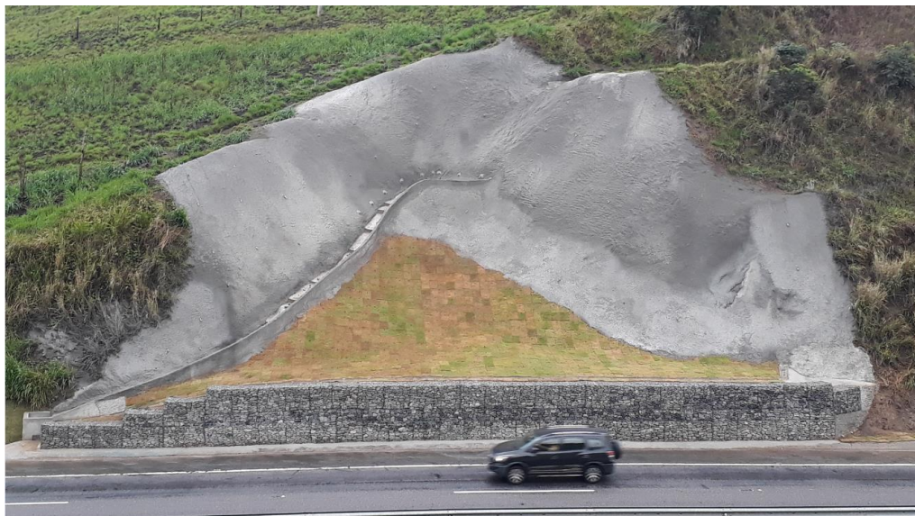
FOTO 34 - Obra de Recuperação de Talude com a solução de solo grampeado (fim) - Km 09+760
