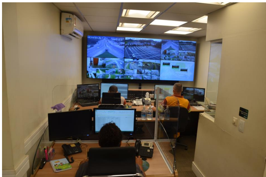
FOTO 16 – Interior do CCO - Km 21+500
