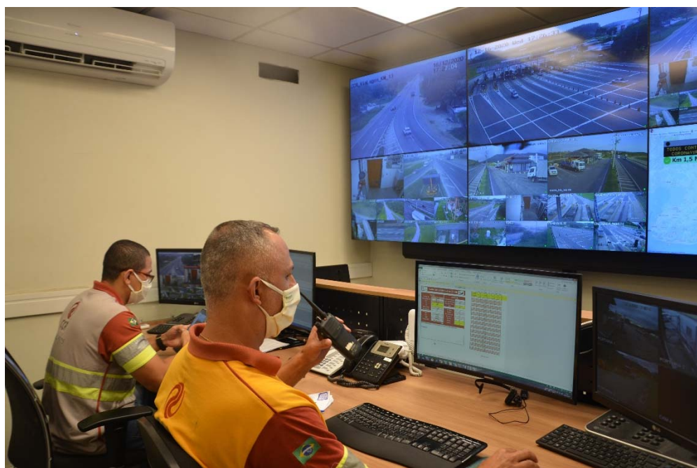
FOTO 14 – Interior do CCO - Km 21+500
