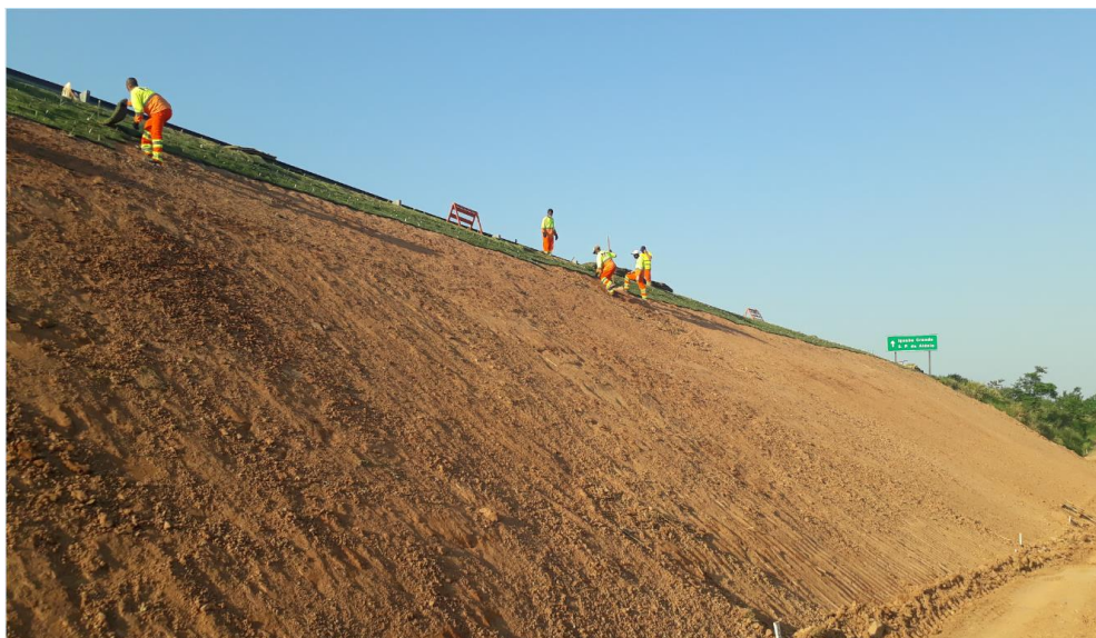
FOTO 31 - Obra de Recuperação de Talude com a solução de retaludamento e replantio (início) - Km 30+080
