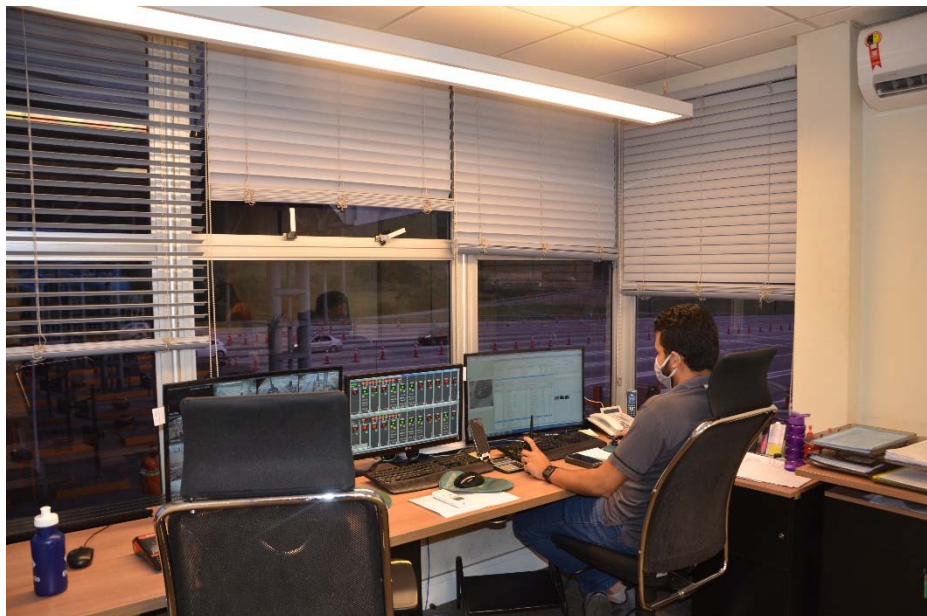
FOTO 15 – Interior do CCO - Km 21+500
